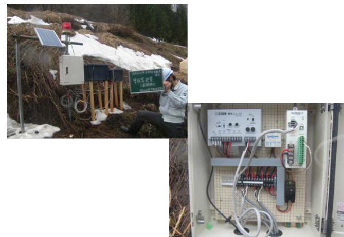
写真-2 通信設備設置状況
